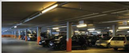
Ennen 58W T8 Loisteputket
